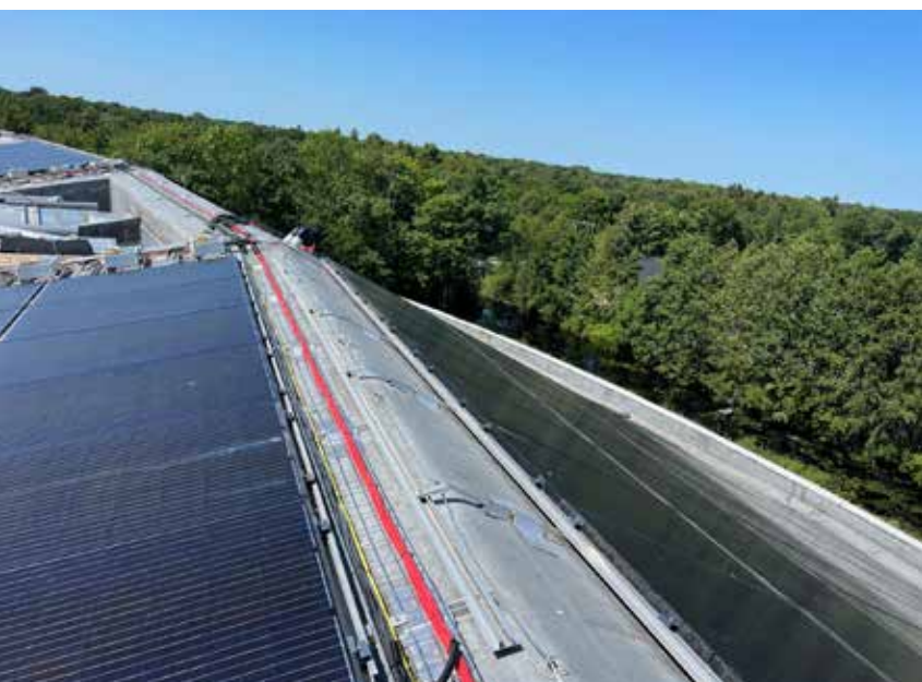
Zonnepanelen op het Thialf gebouw.
